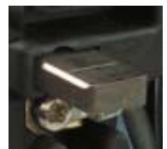
Visuele inspectie van de koolborstels is erg eenvoudig door de aangebrachte markering.
